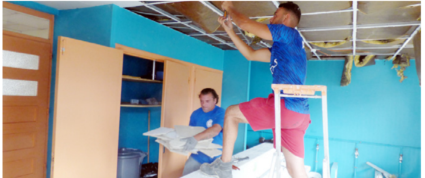
Pendant l'été, des travaux sont entrepris dans les toilettes de l'école Casanova.
